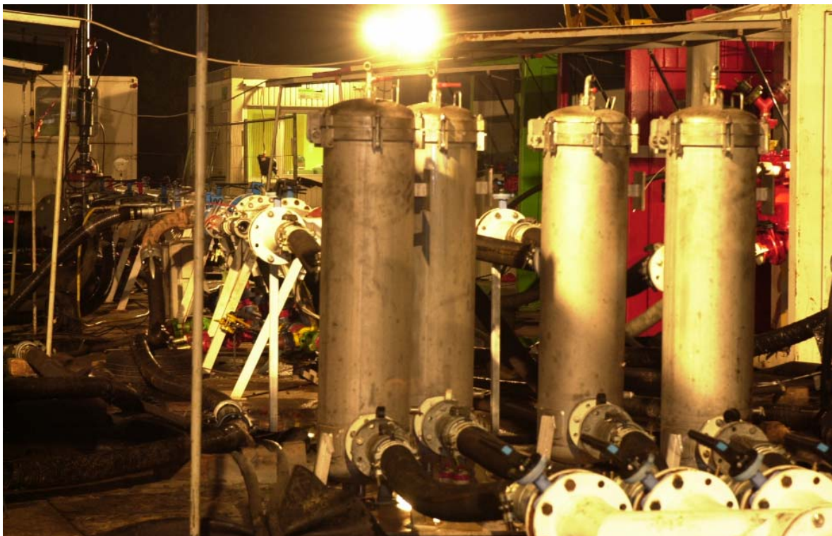
Abb. 9: Filter und Ansaugleitungen für die Hochdruckpumpen. Im Hintergrund ist das Niederdruckmanifold zu erkennen.
